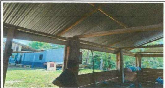
Foto 4: SE REQUIERE LA FINALIZACION DE LA COCINA CON BLOCK, ESTRUCTURA DE TECHO Y CUBIERTA DE LAMINA
